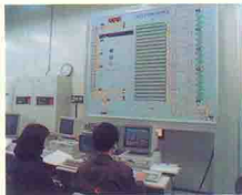
اتاق کنترل مرکزی
