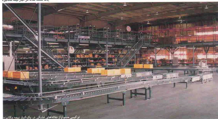
ترکیبی متنوع از نقاله‌های غلتکی در یک انبار نیمه مکانیزه
