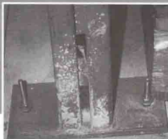
اتصال نادرست کف ستون به کف انبار
